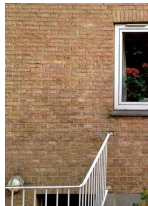
ØVERST Fortunbyen, Kgs. Lyngby. Mindre sætningsrevner uden konstruktiv betydning. Reparation, hvor jerngelænder går i murværket.
