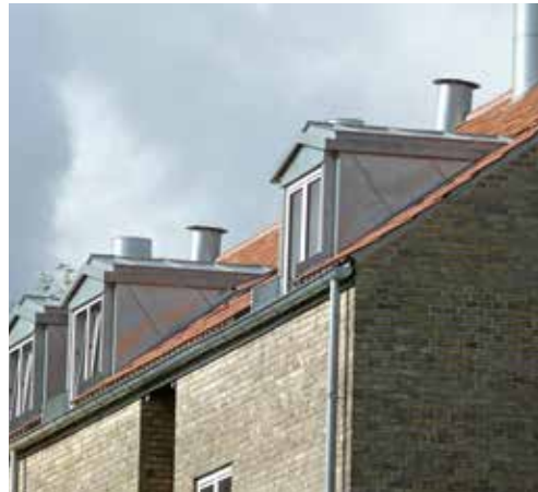
Udskiftning af tag samt efterisolering er lykkedes, uden at tagprofilen er ændret.
