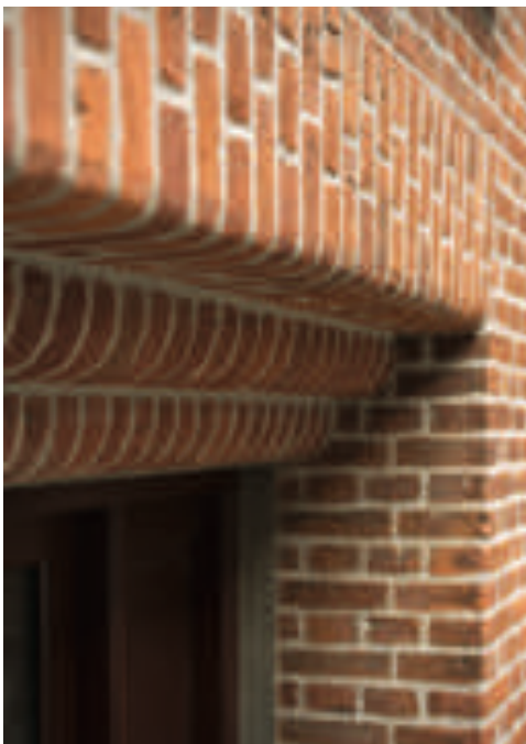
Der er mange fine detaljer i Teglgården, som vidner om tidens høje håndværksmæssige kvalitet. Her en vinduesåbning med rundede mursten.
