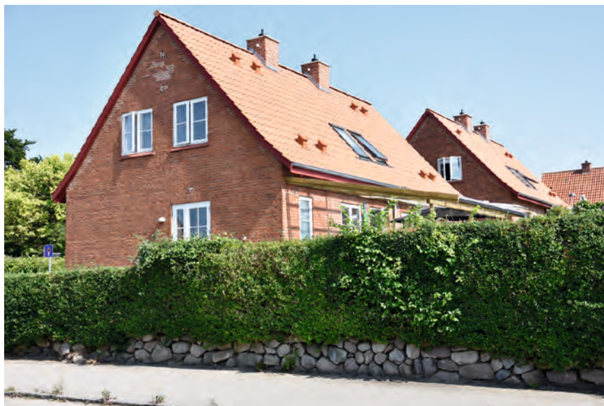
FIGUR 3. De små bygninger på Bent Grubes Vej i Holbæk har fået repareret murværkets fuger. Alligevel vurderer boligselskabet, at fuger og sokler skal repareres yderligere inden for en kort årrække.
