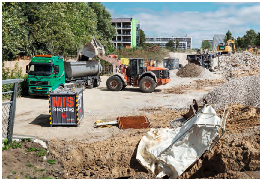
FIGUR 55. De fysiske omdannelser i Gellerupparken har allerede været mange år, og flere beboere klager over et rodet forløb, hvor der har været en stor udskiftning af byggeledere undervejs.
