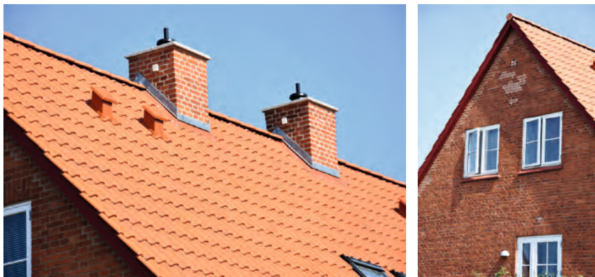
FIGUR 78. Skorstene er blevet bevaret og sat i stand, mens facaderne er blevet pletvist repareret. Det vurderes, at facader og sokler har behov for yderligere istandsættelse inden for en overskuelig årrække.
