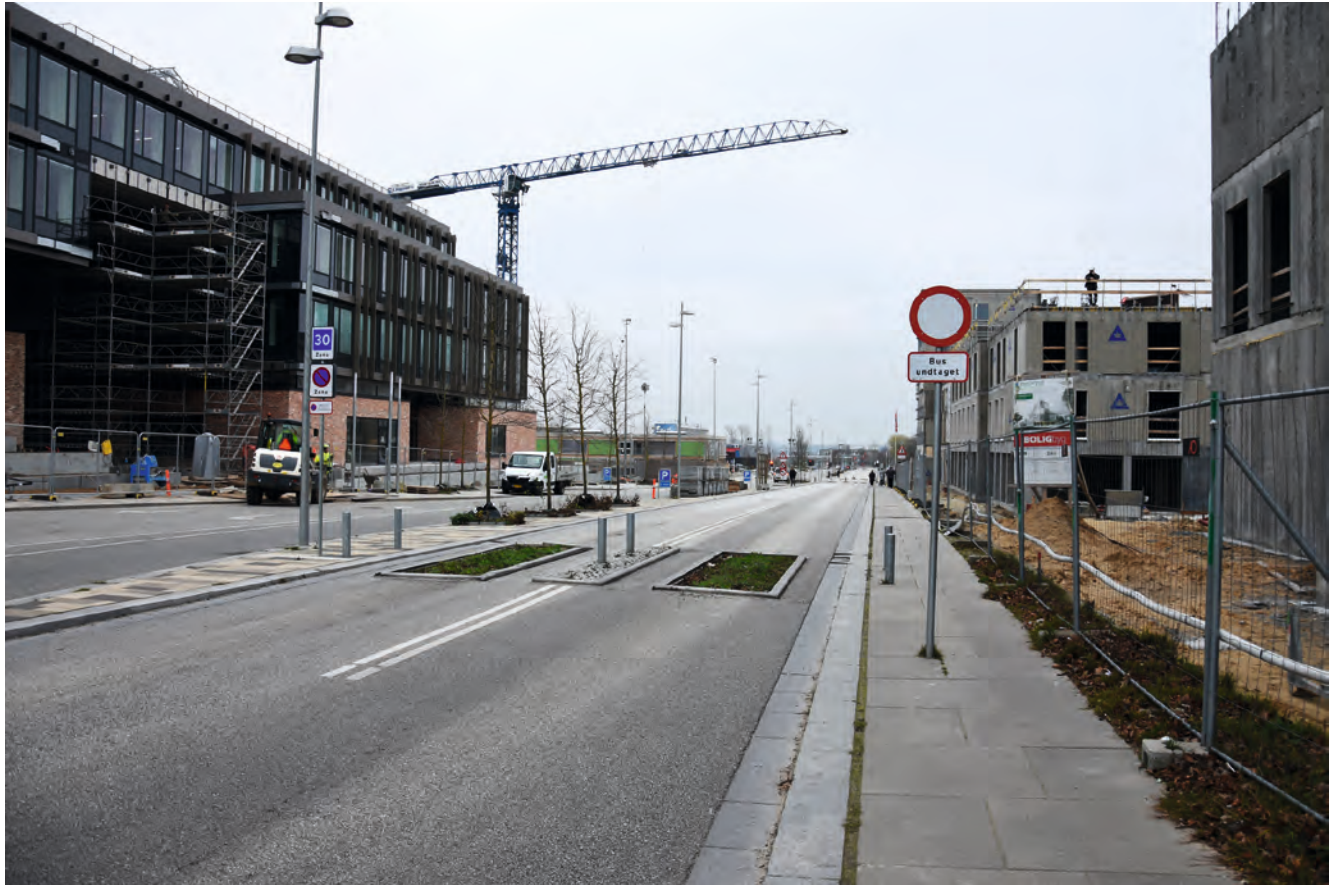
FIGUR 18. Renoveringen af Blok 4 og Blok 7 i Gellerupparken skal ses i sammenhæng med andre store investeringer i bydelen. Her ses fx til venstre det kommunale kontorhus Blixen i den ene ende af en ny vejføring, Karen Blixens Boulevard (fotograferet dec. 2018).
