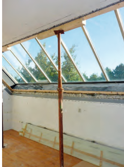
FIGUR 82. Al bygningsmateriale er skåret væk fem centimeter rundt omkring dørparter, vægge og lofter er blevet sandblæst, og alle gulve er udskiftet. Foto: Marie Frederiksen.
