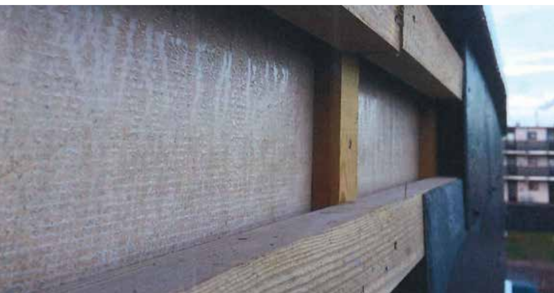
Vand fra MGO plader.
