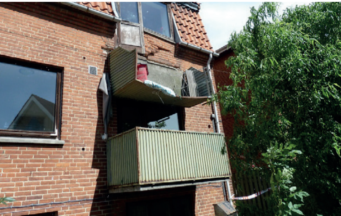
Privat udlejning, Nykøbing Falster Altankollaps ved uvarslet brud i udliggerjern
