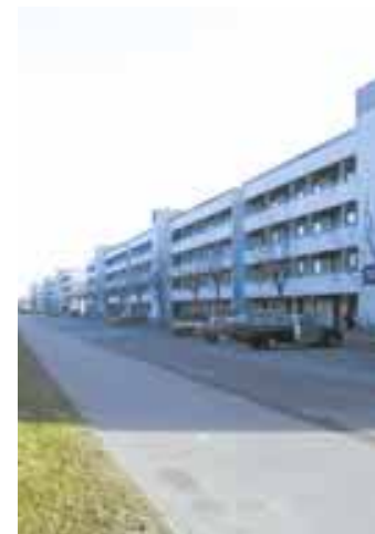
Facaderne er nedslidte.
