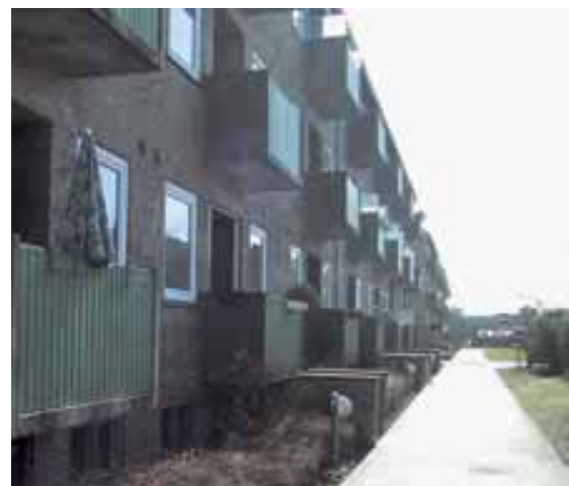
De eksisterende altaner er nedbrudte.
