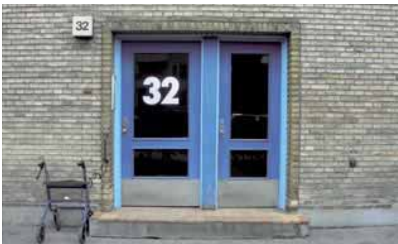
Dårlig tilgængelighed for gangbesværede..
