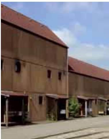
Facadeelementerne er nedbrudte.
